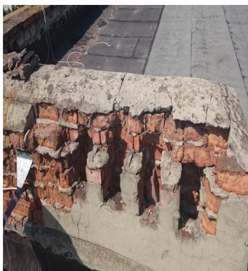
Рис. 5. Разрушение кирпичных выпусков вентиляционных каналов на крыше здания
