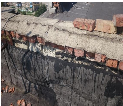
Рис. 3. Выветривание швов кирпичной кладки
