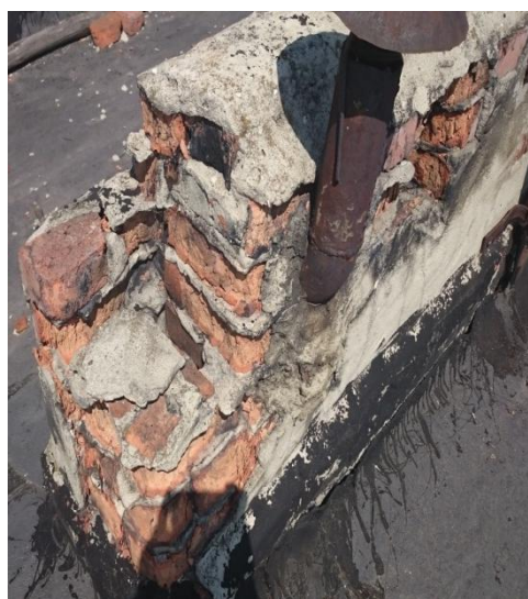
Рис. 6. Разрушение кирпичных выпусков вентиляционных каналов на крыше здания
