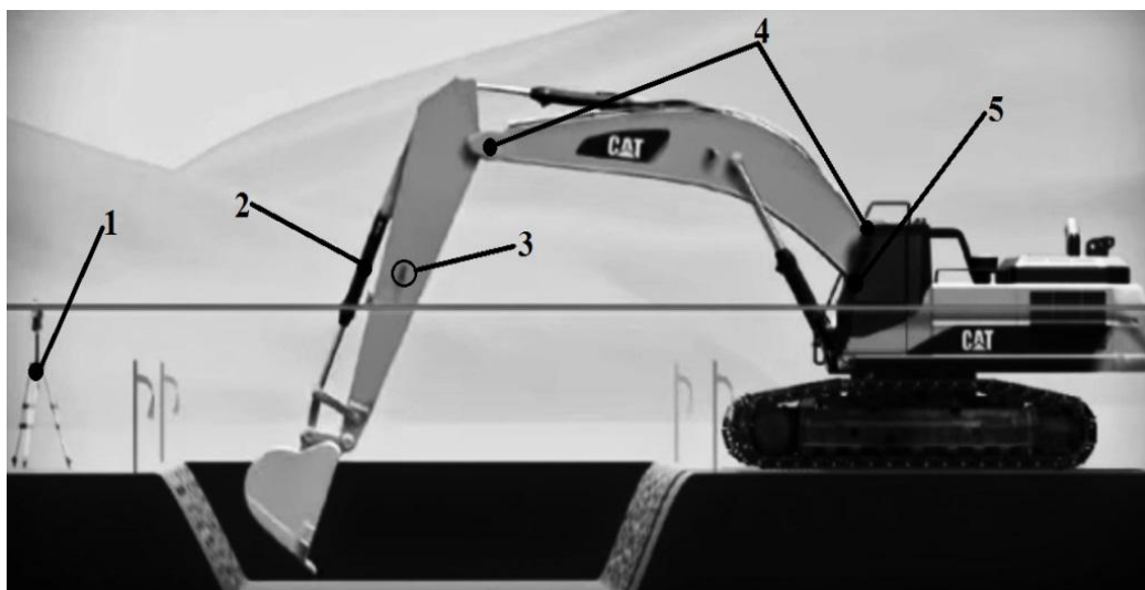
Рис. 2. Компоненты системы автоматизации экскаватора: 1 – тахеометр; 2 – цилиндр с сенсором положения; 3 – лазерный приемник; 4 – датчики положения стрелы; 5 – блок управления
