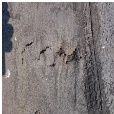
Рис. 2. Разрывы кровельного ковра
