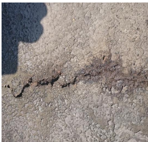
Рис. 1. Разрывы кровельного ковра
