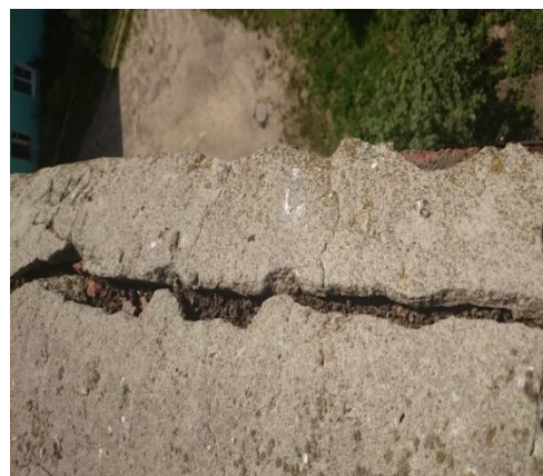
Рис. 4. Отслоение цементно-песчаного слоя парапета
